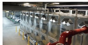
厨房排水処理施設
