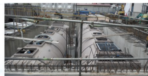
合併処理浄化槽
